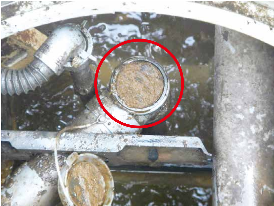
汚泥循環エアリフトポンプのようす
