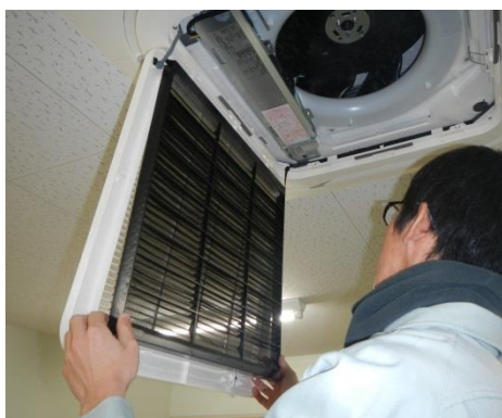
【エアコンフィルターの清掃】
