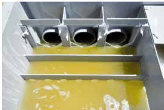
分水計量装置の状況
