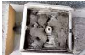
送風機のフィルター劣化
