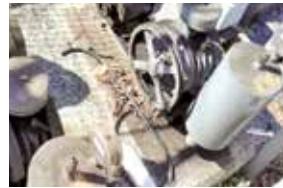
送風機のベルトが切れているようす
