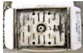
送風機のフィルター未設置
