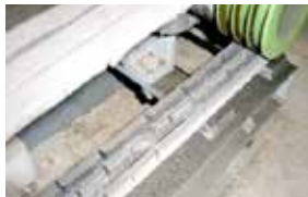
送風機のベルトの亀裂
