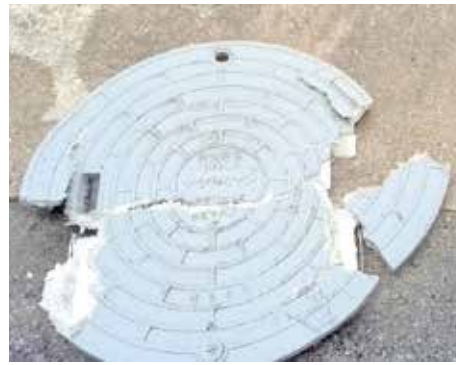
マンホール蓋の破損
