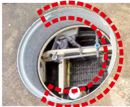
マンホール蓋受枠の破損
