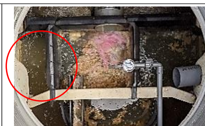
沈殿分離槽1室にて、ばっ気あり
