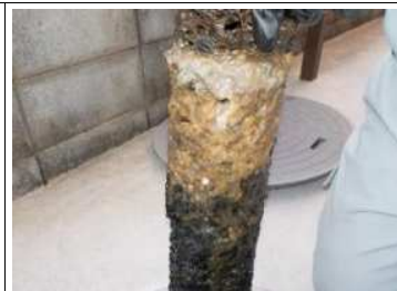
(接触材の目詰まりのようす)
