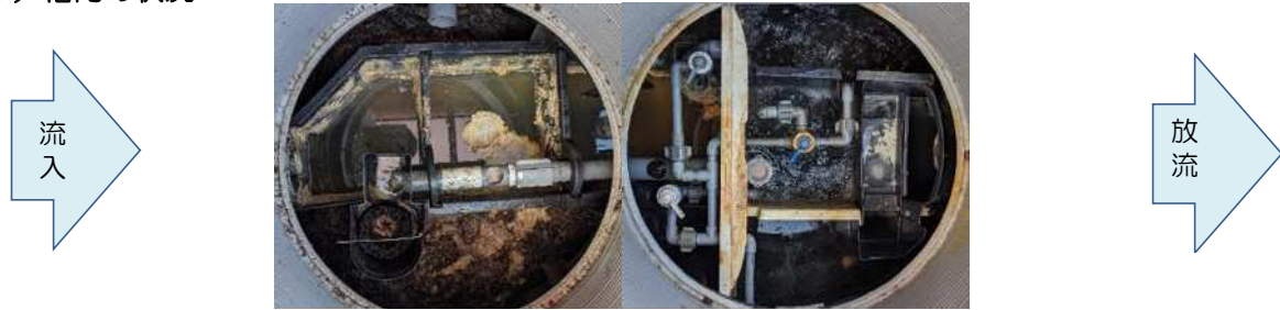
①汚泥貯留槽 ②担体流動槽 ③沈殿槽及び消毒槽
